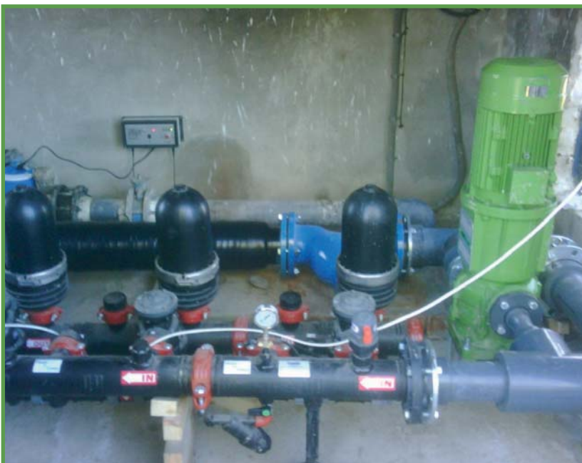
S.A.T. de riego por goteo de cepas para obtención de vino con denominación de origen RIOJA (ANDOSILLA, Navarra)
