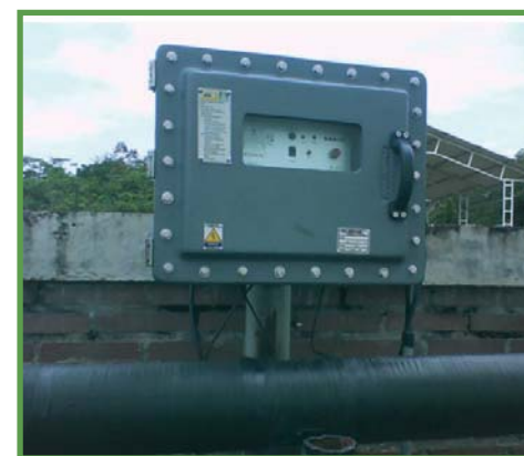
ECOPETROL COLOMBIA. Circuitos de re inyección de agua.
