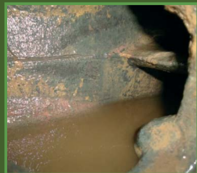
Vista interna cilindro compresor de gas. PLANTA BONANZA (Colombia)
