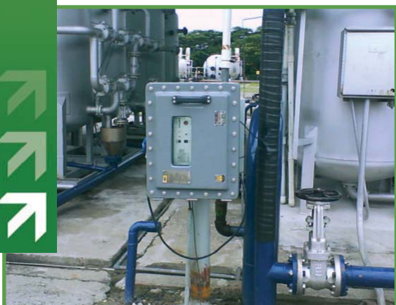
ECOPETROL COLOMBIA. Protección generadores vapor
