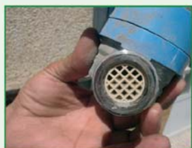
Filtro contador de agua.
