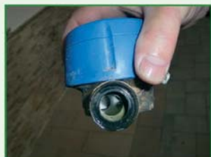
Contador de agua.
