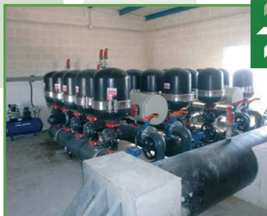
Bombeo y cabezales de filtrado
