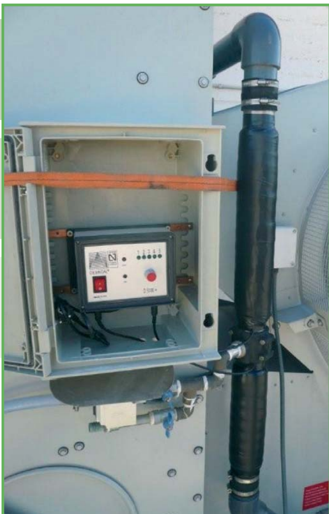
PREELABORADOS ALIMENTARIOS. Petrer (Alicante) Protección condensador evaporativo
