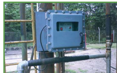
ECOPETROL COLOMBIA. Estación com- presora CAMPO BONANZA. Protección cilindros compresores gas
