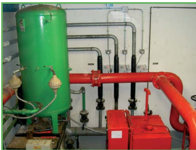
DONUTS PANRICO. (STA. PERPETUA DE MOGODA, Barcelona) Protección aportes red ACS y hornos
