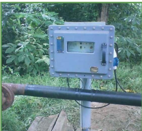
ECOPETROL COLOMBIA CAMPO TECA. Circuitos de re inyección de agua
