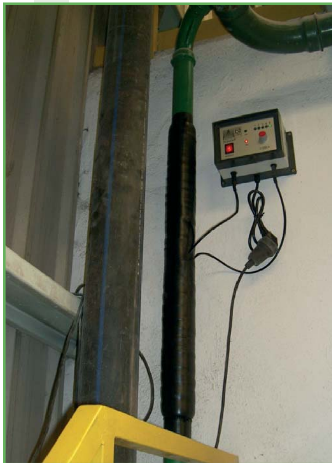
ECOPARC BARCELONA. Planta Lixiviados. Protección circuitos de separación y tratamiento de residuos
