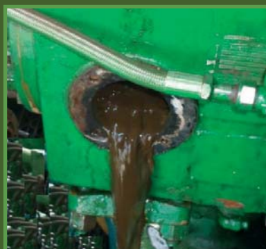
Cilindro compresor de gas. Efecto de la desincrustación por acción DESINCAL. Estación compresora ECOPETROL PLANTA BONANZA
