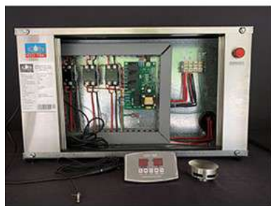
Vista de gabinete por dentro
